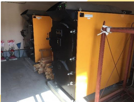
真庭市 中和地区 薪ボイラー
